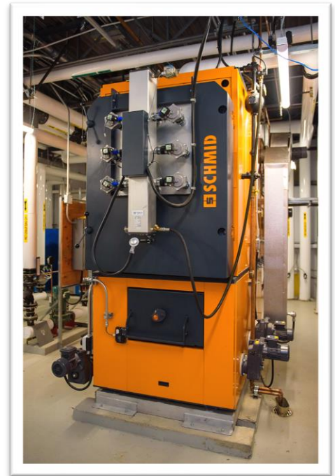
La chaudière industrielle à biomasse Schmid installée au CFAM.
